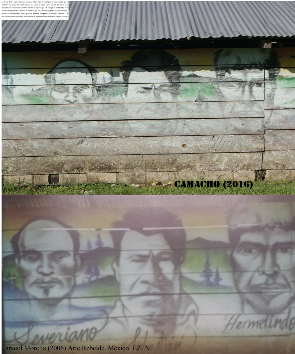
Figura 4. Deterioro de mural en Caracol IV Morelia Torbellino de Nuestras Palabras de 2006 a 2016.
